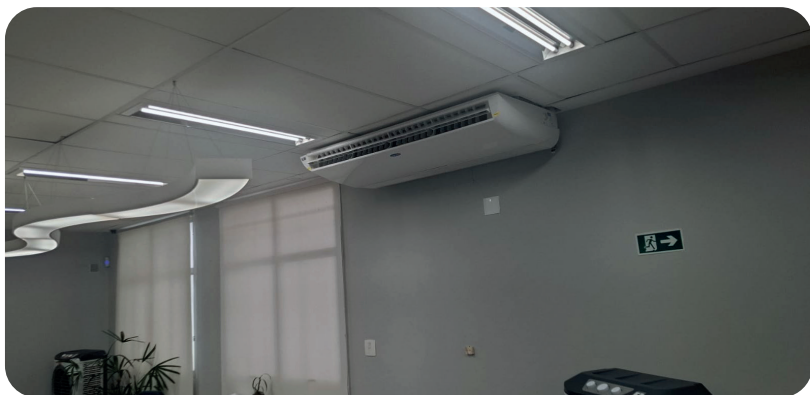
Na agência Ipanema, novos e grande aparelhos foram instalados e já estão funcionando. Foto amadora.
